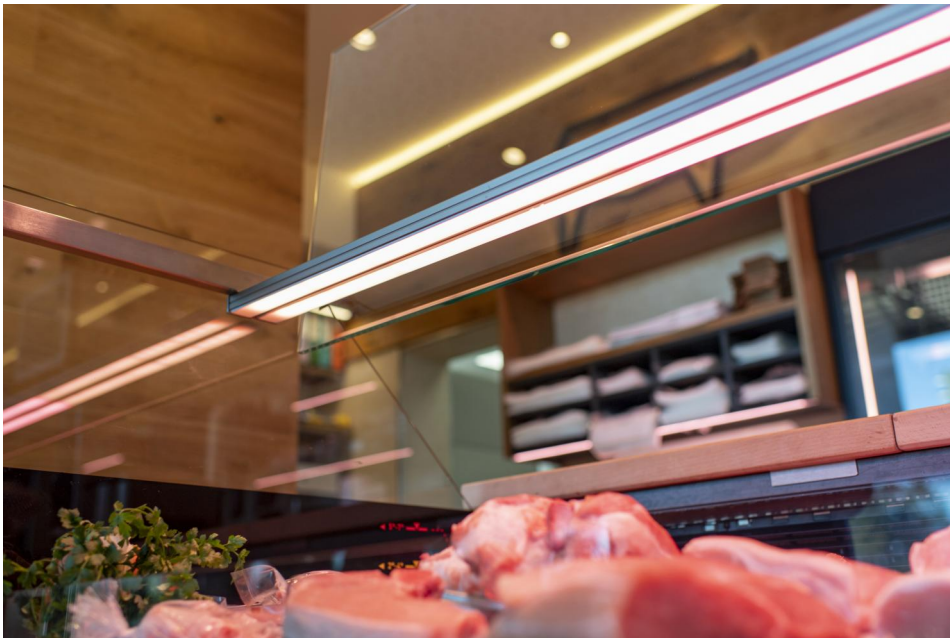
Ideal ist eine die Kühltheke integrierte LED- Beleuchtung. Diese emittiert wenig IR- und UV-Strahlung, zudem entsteht an der Lichtaustrittsquelle keine Wärme. © Aichinger
