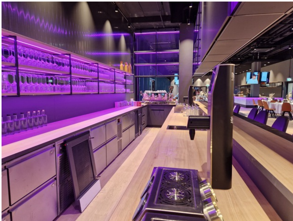
Im neuen Linzer LASK-Stadion wurde die innovative Schankanlage bereits installiert. www.fh-kufstein.ac.at www.fh-kufstein.ac.at (© Schankschmiede GmbH)
