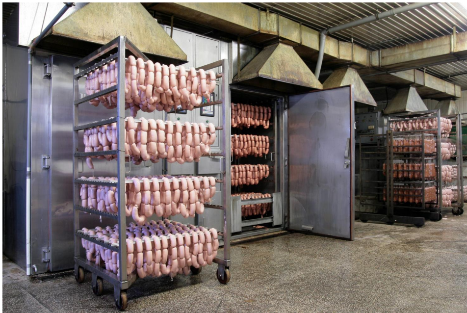
In der Fleischindustrie werden in 90 Prozent der Fälle für die Prozesswärme Temperaturen von mehr als 100 Grad Celsius benötigt. © BKtech
